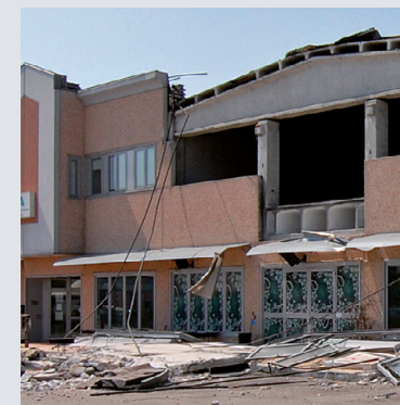
Crollo di elementi di facciata (Emilia Romagna, Italia, 2012).
