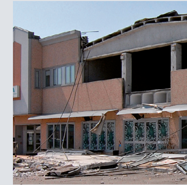
Abgestürzte Fassadenbauteile (Emilia Romagna, Italien, 2012)
