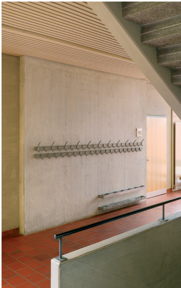
Die neuen Treppenhauswände werden bewusst gezeigt. Ein schönes Detail: die alten verzinkten Garberobenhaken wurden wieder montiert.
