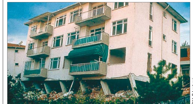
«Soft-storey»: Unterbruch der aussteifenden Wände im Erdgeschoss. Diese Schwachstelle kommt in der Schweiz oft vor.
